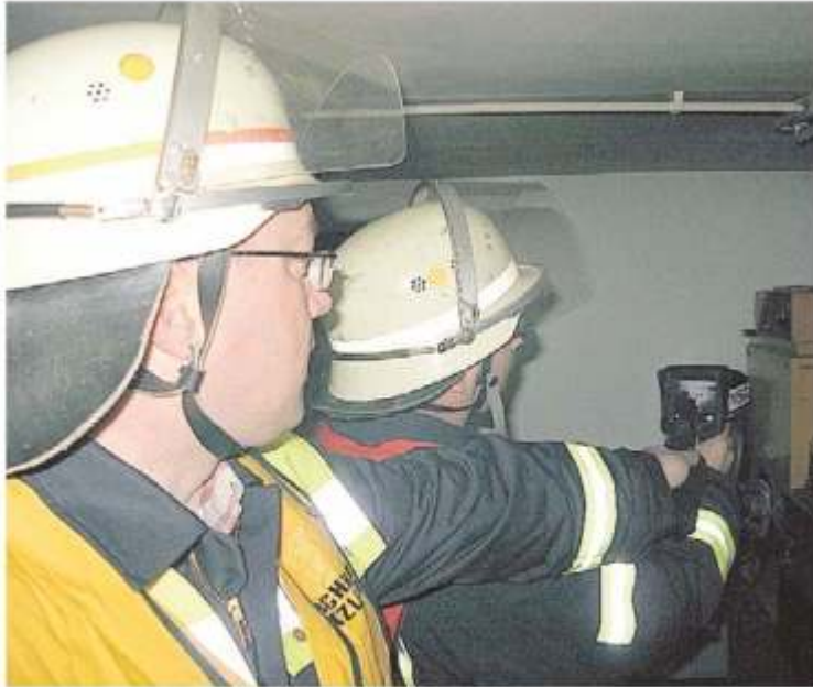
Reinhold Bonacker (links) und Maik Flache prüfen mit einer Wärmebildkamera die Temperatur in der Kellerwand. Foto: Lerchbacher
